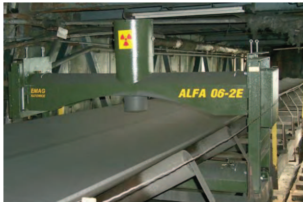
Rys. 2. ALFA-06-3E w zakładzie mechanicznej przeróbki węgla Рис. 2. Система ALFA-06-3E на обогатительной фабрике
