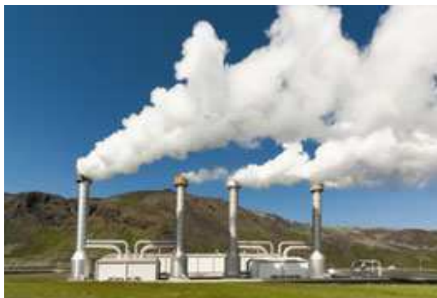
Rys. 5. Elektrownia geotermalna, źródło: www.thinkgeoenergy.com Fig. 5. A Geothermal Power Station, source: www.thinkgeoenergy.com
