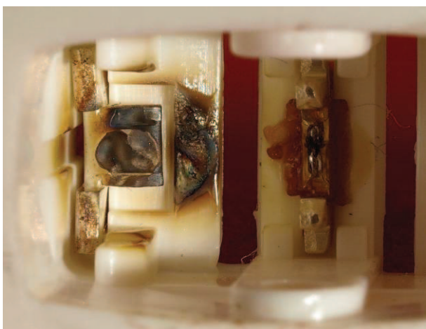
Rys. 5. Widok degradacji powierzchni styku nieruchomego (rozłącznego) oraz materiału obudowy w jego pobliżu w łączniku produkcji angielskiej, po wykonaniu 600 cykli łączeniowych
