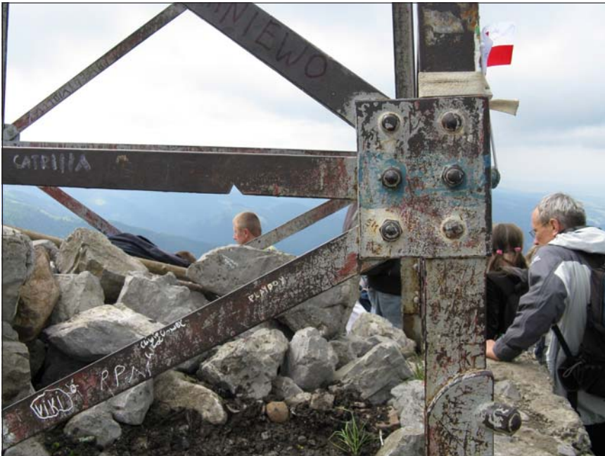
Rys. 4. Miejsce pobrania próbki z konstrukcji stalowej krzyża w jej dolnej części. Fot. I. Wąs
