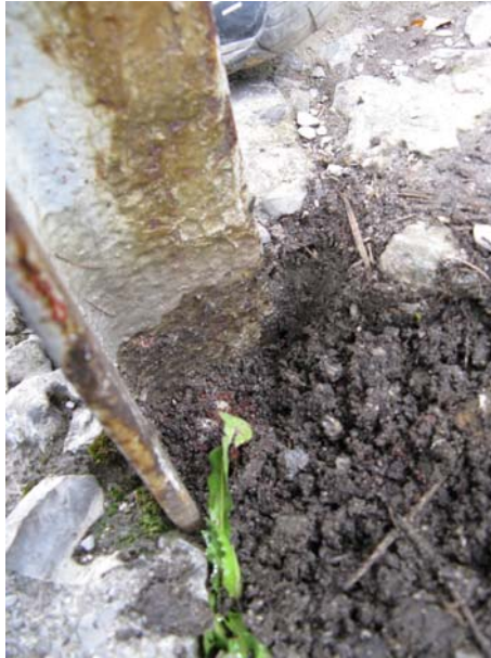
Rys. 8. Mocowanie podłużnicy krzyża w fundamencie w jego części południowo-wschodniej. Widoczna kawerna w betonie wypełniona humusem. Fot. A. Ciszewski
