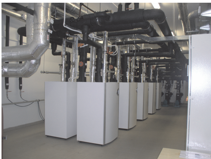
Rys. 2. Widok pomieszczenia z zainstalowanymi pompami ciepła Greenline D70 w części piwnicznej nowej auli VSB-TU Ostrawa
