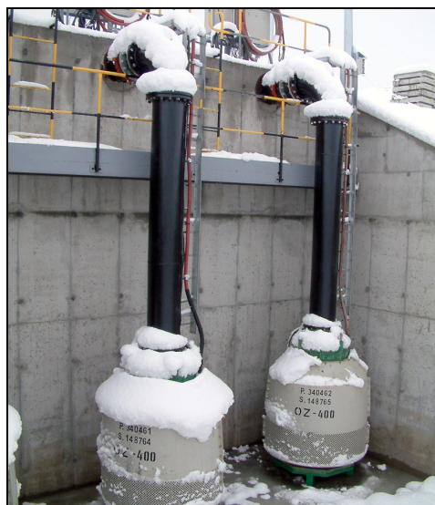
Rys. 14. Pompy OZ posadowione na dnie komory pomp wraz z rurociągami tłocznymi [7]
