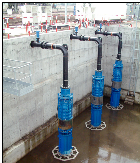
Rys. 13. Pompownia z zespołami pompowymi zatapialnymi wielostopniowymi OWZ-250A/4 [7]
