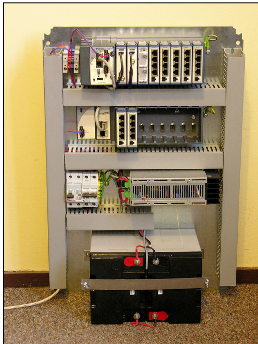
Rys. 3. Skrzynka sterownicza z zamontowanymi modułami systemu ciągłego monitoringu stanu wyężenia ustrojów nośnych maszyn podstawowych górnictwa odkrywkowego
