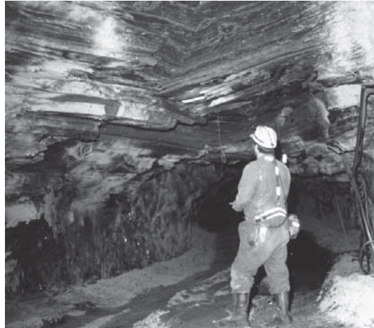
Rys. 1. Destrukcja stropu wyrobiska górniczego na skutek działania wzmożonych naprężeń poziomych [6]
