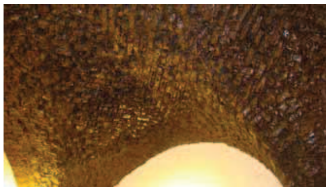
Fig. 20. Stopiony ceglany strop w kaplicy klasztornej opactwa Benedyktynów, fot. J. Dąbrowski • Molten roof bricks in the chapel of the Benedictine Convent in Jarosław, phot. J. Dąbrowski
