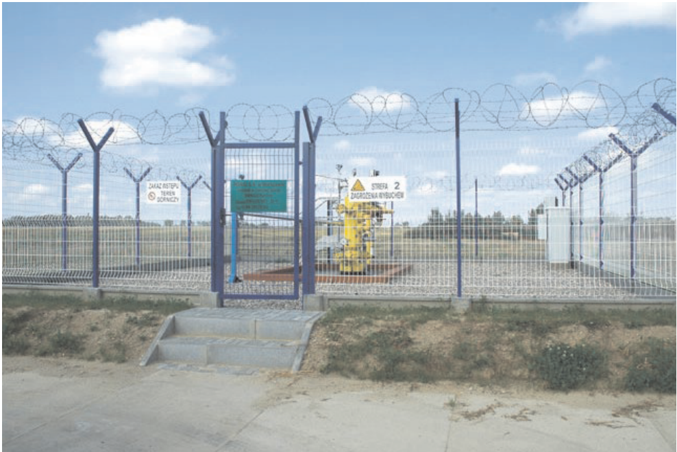
Rys. 2. Widok napowierzchniowego wyposażenia odwiertu „Daszewo-1” dla celów PMG [5]
