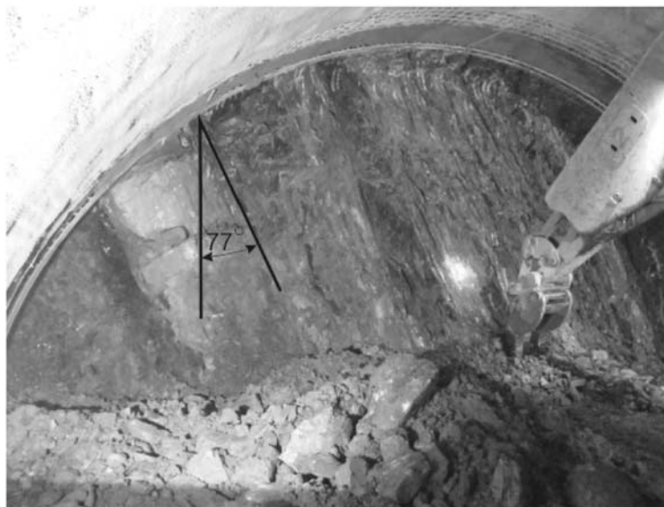
Fot. 1. Układ warstw skalnych w przodku kaloty tunelu „Emilia” (fot. Waleczek E.)
