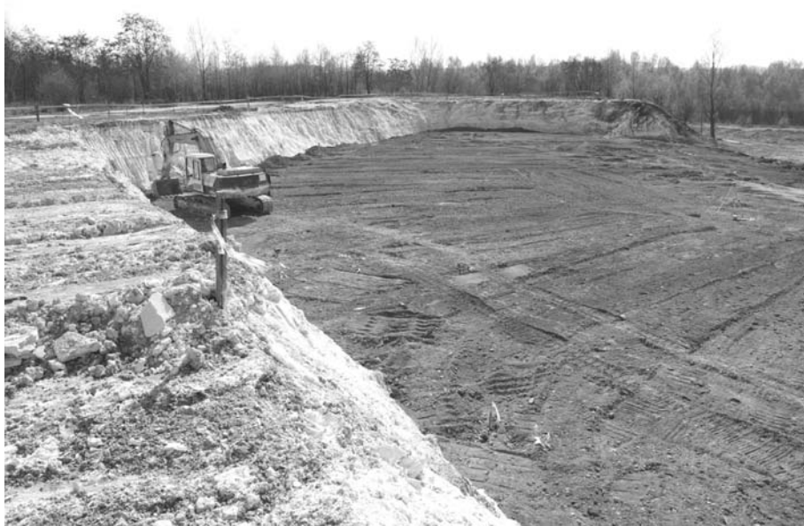
Rys. 6. Wykop budowlany pod obiekty Centrum JP II (Sroczyński, kwiecień 2009, widok w kierunku wschodnim)
