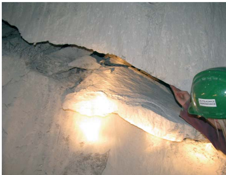
Fig. 2. Zniszczenie ociosu chodnika na kontakcie warstw soli i anhydrytu
