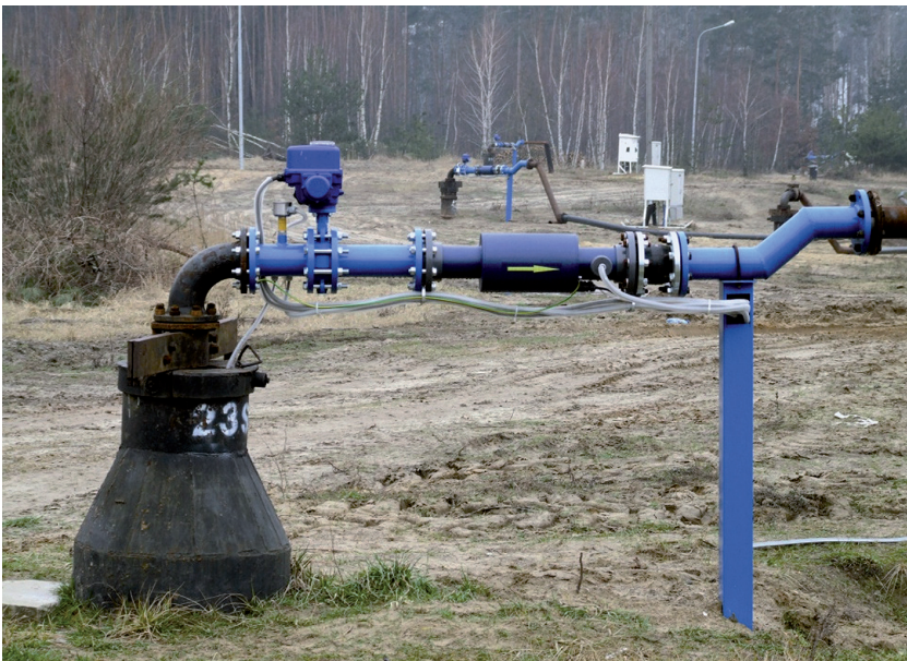
Rys. 2. Studnie bariery ochronnej [6]
