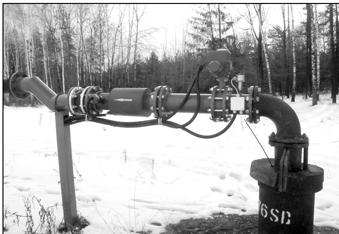
Rys. 4. Urządzenia pomiarowe studni [6]
