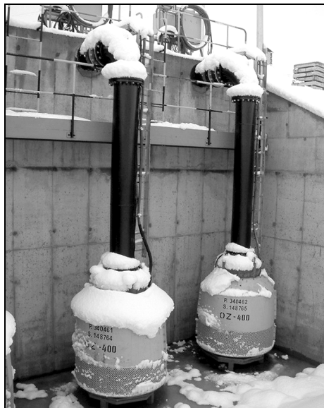
Rys. 13. Pompy OZ posadowione na dnie komory pomp wraz z rurociągami tłocznymi [6]
