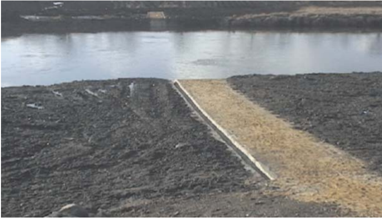
Rys. 2. Komora spustowa do rzeki Odry w miejscowości Olza
