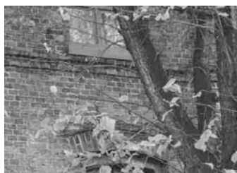
Rys. 11. Uszkodzenie w rejonie ul. Magdorzka
