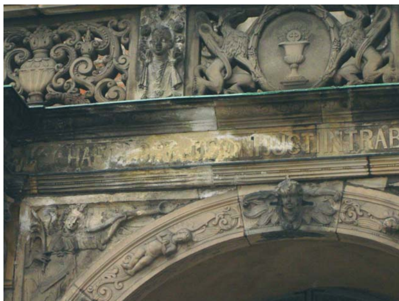
Fig. 3. Fragment portalu południowego kruchty kościoła pw. św. Marcina w Jaworze, zbudowanego z piaskowca pochodzącego ze złoża Czaple. Widoczne są zniszczenia w formie łuszczenia, odpadania agregatów skalnych, zaokrąglenia krawędzi, szorstkości, wykwitów oraz jasnych i ciemnych naskorupień zgodnych z powierzchnią (fot. S. Rosół)
