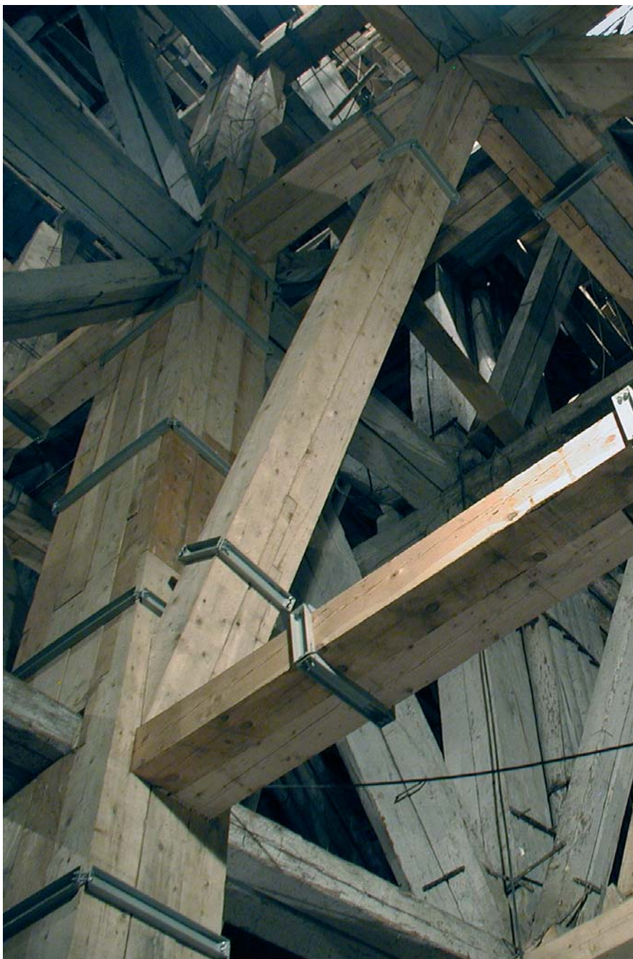
Fig. 10. Fragment nowej wiązki podporowej w komorze Michałowice Fig. 10. Fragment of the new supporting beam in the Michałowice chamber
