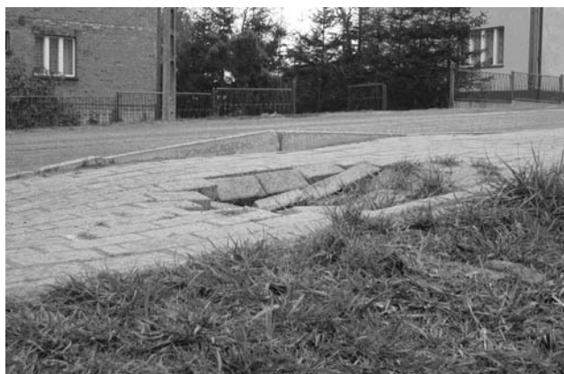
Rys. 7. Wyciśnięte krawężniki oraz wyrwa w chodniku
