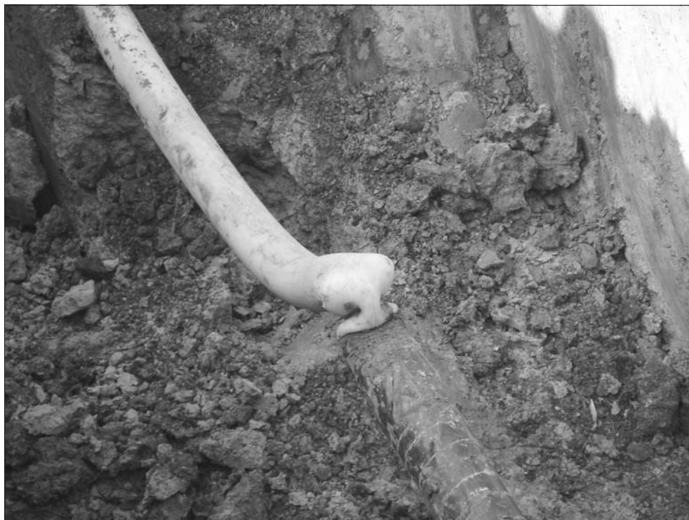
Rys. 14. Zaciśnięta rura polietylenowa Dz 90 [mm], tuż przy przejściu na stal
