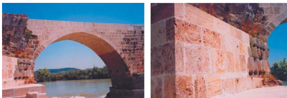
Fig. 4. Współczesne wykorzystanie trawertynu do renowacji zabytkowych obiektów inżynierskich – most Belkis (Turcja)
