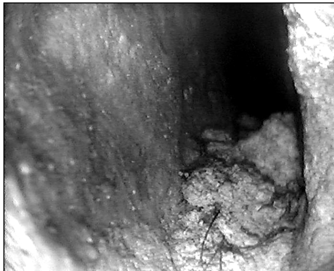
Rys. 6. Szczelina nr 4. Drobne korzenie na głębokości 2,1 m
