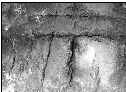
Rys. 5. Szeliny skurczowe w betonie obudowy ciągu C
