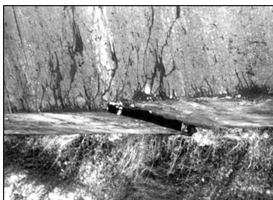
Rys. 4. „Klawiszowanie” obudowy tunelu hydrotechnicznego ciągu odwadniającego C w części fundamentowej
