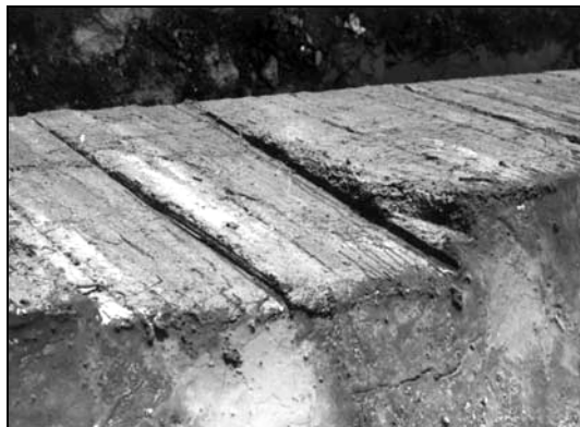
Rys. 3. „Klawiszowanie” obudowy tunelu hydrotechnicznego ciągu odwadniającego C w jej górnej części
