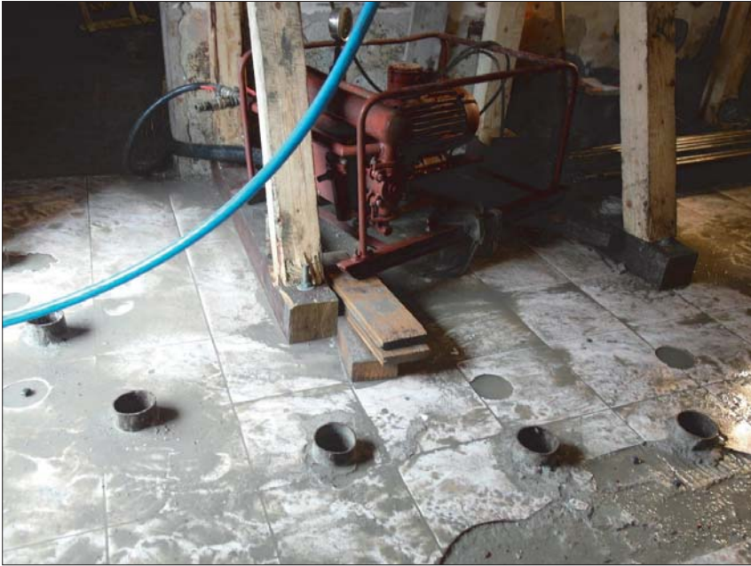
Fig. 7. Otwory cementacyjne pierwszego pierścienia – stan na marzec 2012 r. (fot. J. Przybyło)
