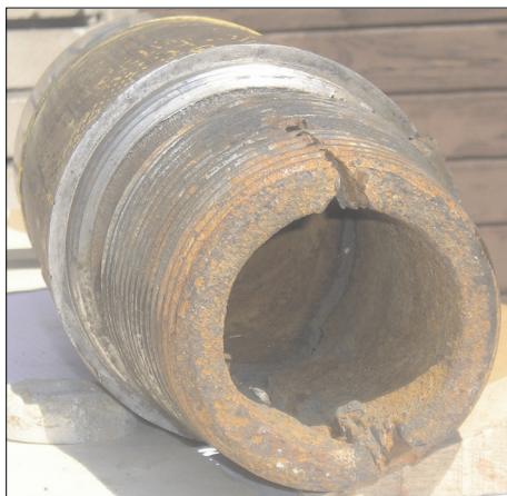
Rys. 8. Czoło końcowe czopa (skorodowane)
