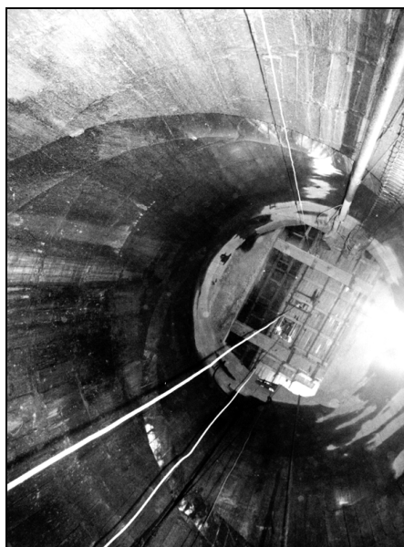
Rys. 3. Zbiornik na poz. 630 m w KWK „Chwałowice” z dwoma zsuwniami spiralnymi w obmurzu
