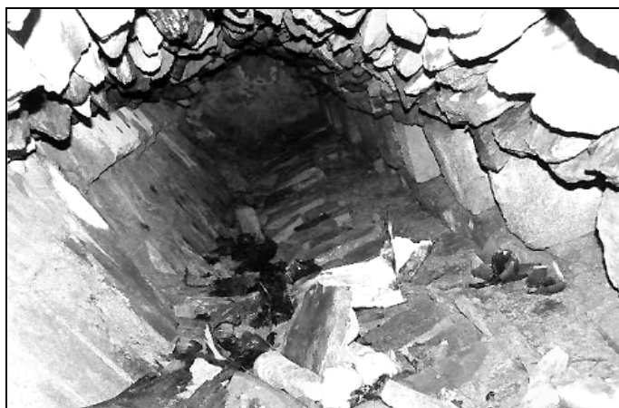
Rys. 4. Widok kanału odwadniającego zbierającego wody opadowe z kierunku od muru dziedzińca ze spływem w kierunku na mur zewnętrzny Donżonu
