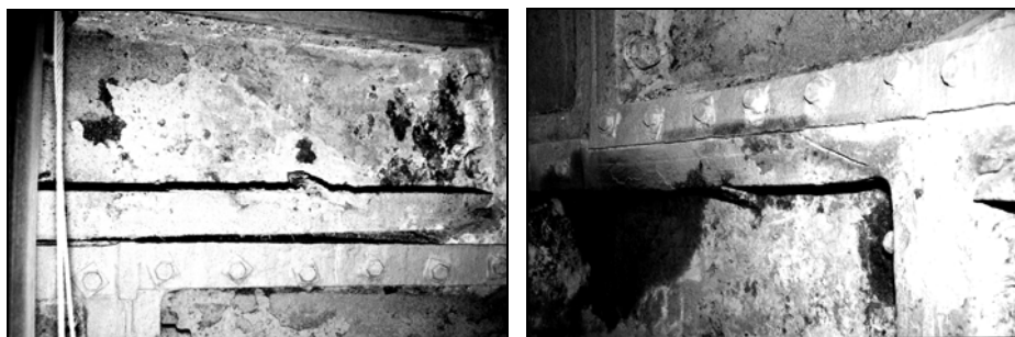
Rys. 1. Uszkodzenia segmentów tubingowych szczeliny pikotażowej nr 8 w szybie L-II kopalni Lubin
