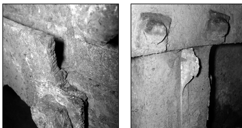
Rys. 3. Zjawiska towarzyszące pękaniu kołnierzy segmentów tubingowych
