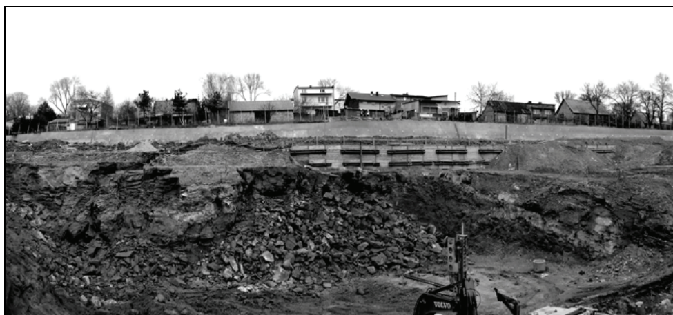
Rys. 1. Widok na skarpe północną w początkowej fazie osuwiska
