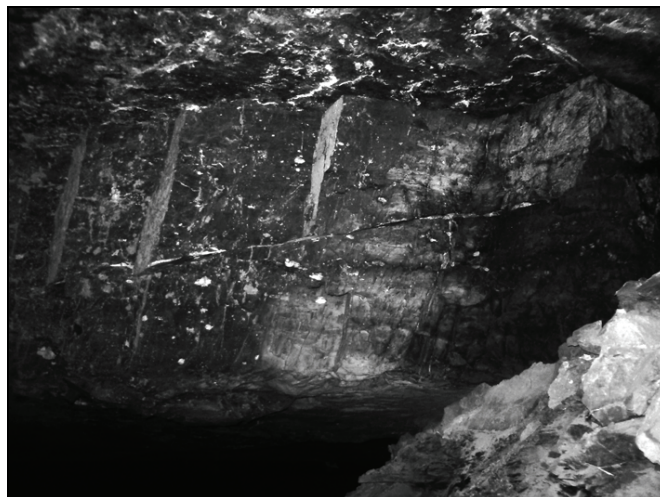
Rys. 8. Wypełniona szczelina (efekt subhoryzontalnego ścinania w warunkach ekstensyjnych) wraz z towarzyszącymi pionowymi i stromo nachylonymi spękaniami — pole G-7/5 oddziału G-7 kopalni „Rudna”
