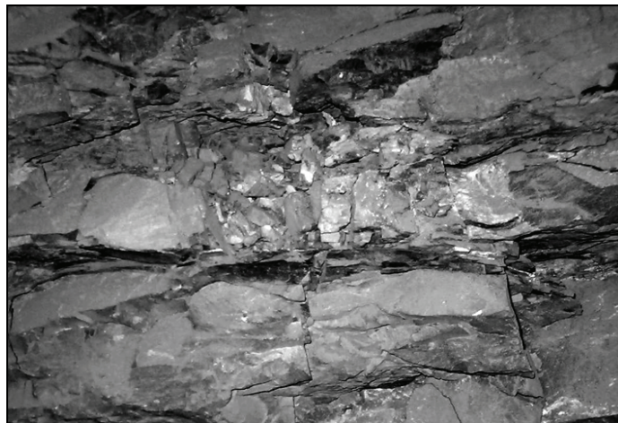
Rys. 14. Współczesne zniszczenie warstw dolomitu — pole G-7/5 oddziału G-7 kopalni „Rudna”
