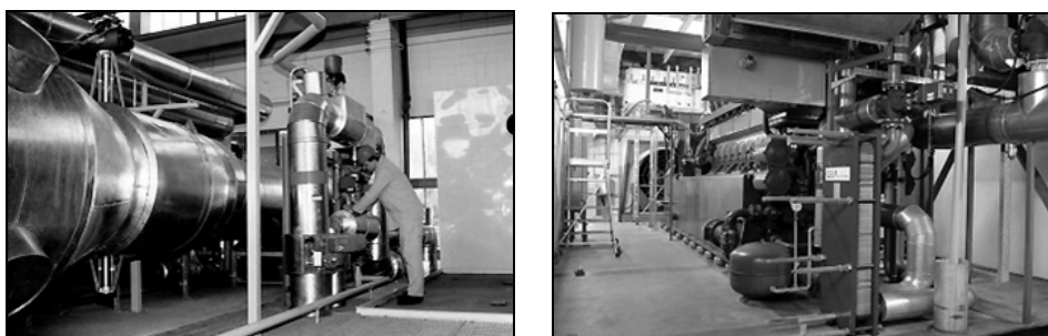
Rys. 16. Instalacja skojarzonego układu energetyczno-chłodniczego w KWK „Pniówek”
