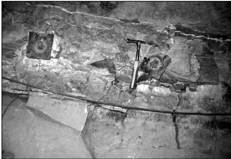
Rys. 7. Szczeliny wypełnione anhydrytem oraz tektonicznie naruszona spągowa strefa warstw cechstynu
