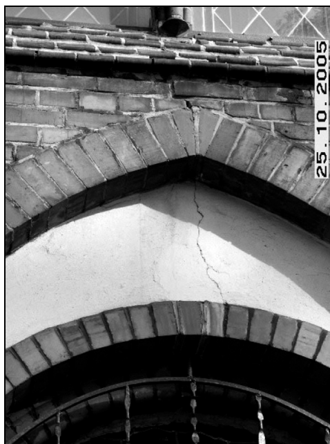
Rys. 4. Przykład uszkodzenia ściany zewnętrznej
