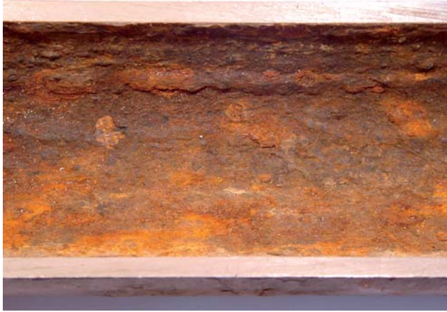
Rys. 8. Wygląd rury silnie skorodowanej od strony wewnętrznej (rura nr 3')
