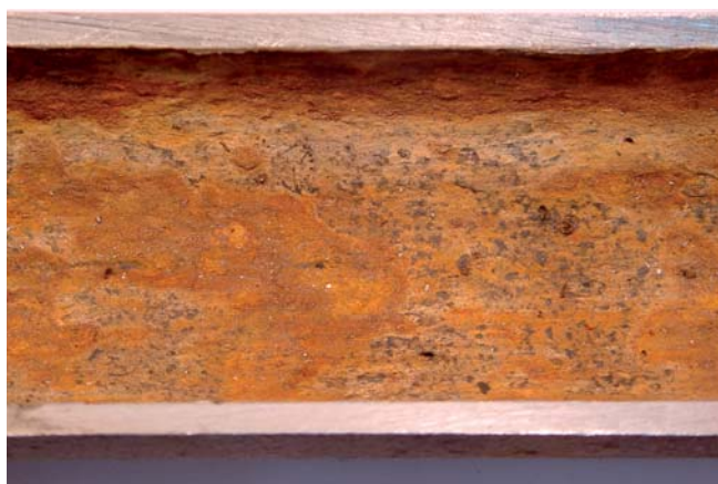
Rys. 7. Wygląd rury silnie skorodowanej od strony wewnętrznej (rura nr 3')
