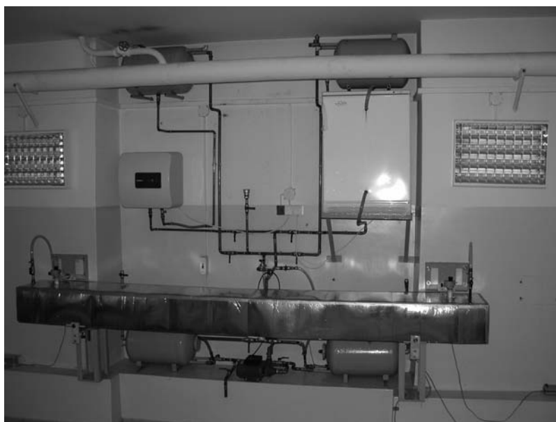
Rys. 1. Komora techniczna GLM WGGiŚ AGH
