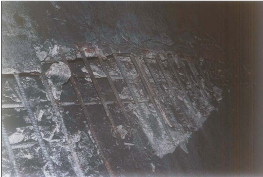
Rys. 3. Odspojenie warstwy otuliny betonowej wraz ze zbrojeniem ukośnej północno-wschodniej ściany podłużnej leja zsykowego
