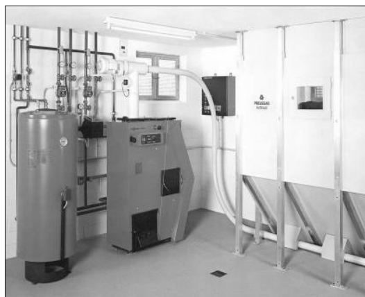
Rys. 4. Bezobsługowa kotłownia z piecem retortowym
