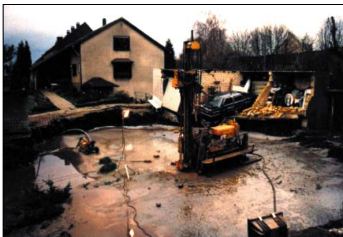
Rys. 3. Zapadlisko wypełnione materiałem betonopodobnym [8, 9]
