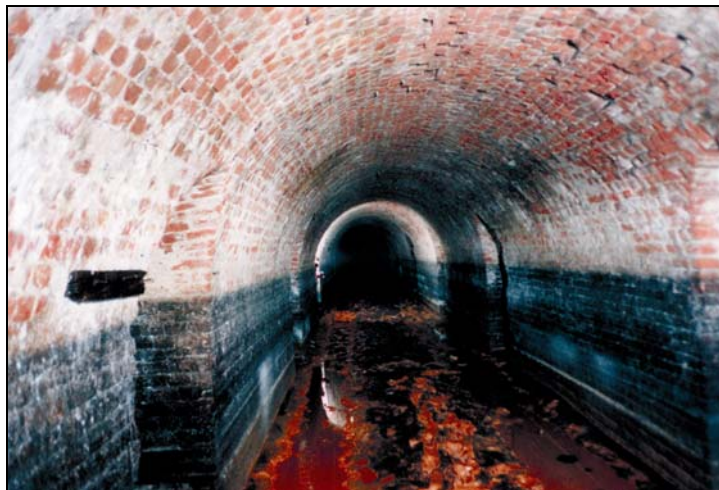
Rys. 2. Wnętrze tunelu fortecznego w kierunku zachodnim ze śladami wysokości zalewania przez wody opadowe
