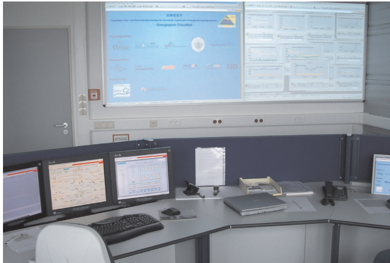
Rys. 5. Widok pomieszczenia z panelami operatorskimi dla systemu zarządzania energią (foto: A. Penczek)
