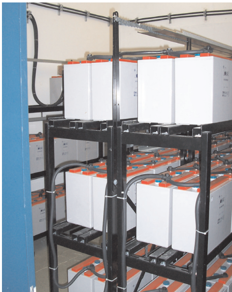
Rys. 7. Pomieszczenie z baterią akumulatorów dla systemu kondycjonowania energii (foto: A. Penczek)
