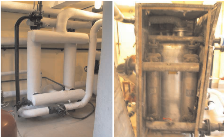
Rys. 2. Wymienniki CO i CWU wraz ze zbiornikiem ciepłej wody w węźle ciepłowniczym jednego z akademików Miasteczka Studenckiego AGH
