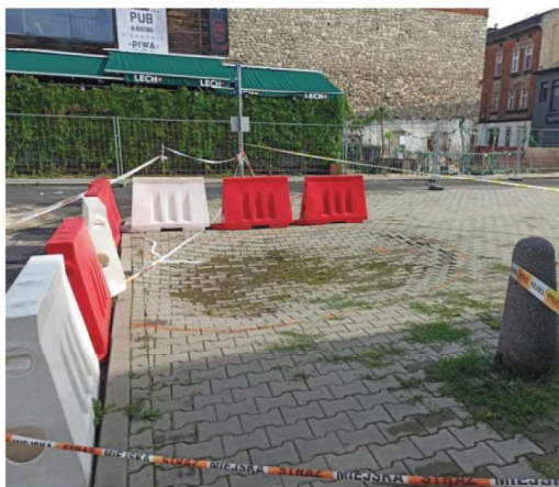
Fot. 1. Zapadlisko B (fot. S. Siwek) Fot. 1. Sink-hole B (S. Siwek)
