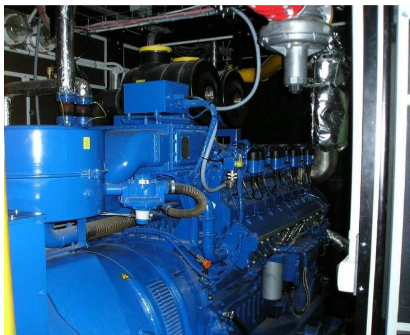
Rys. 5. 16-cylindrowy silnik biogazowy kogeneratora zainstalowanego w Oczyszczalni Ścieków Kraków Płaszów II (2 jednostki, znamionowa moc elektryczna jednostki - 800 kW, moc cieplna - 810 kW)
