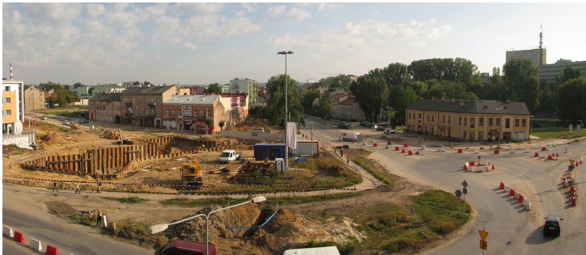
Fot. 3. Węzeł Żelazna – budowa ronda turbinowego z dwoma przejściami podziemnymi dla pieszych Źródło: [2]
