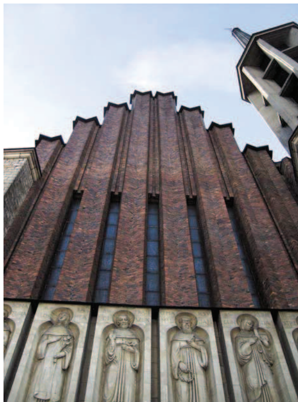
Ryc. 6. Odchylenia sterczyn na fasadzie głównej, fot. M. Łaba, październik 2011 Fig. 6. Deviations of pinnacles on the main facade, photo: M. Łaba, October 2011
