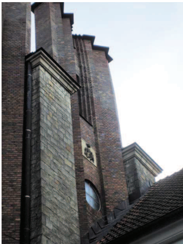
Ryc. 5. Deformacje sterczyn po stronie zachodniej, fot. M. Łaba, październik 2011 Fig. 5. Deformations of pinnacles on the west side, photo: M. Łaba, October 2011
