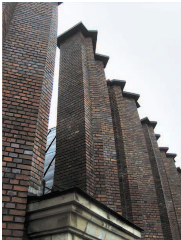
Ryc. 4. Widoczne odchylenia sterczyn po stronie zachodniej, fot. M. Łaba, październik 2011 Fig. 4. Visible deviations of pinnacles on the west side, photo: M. Łaba, October 2011
