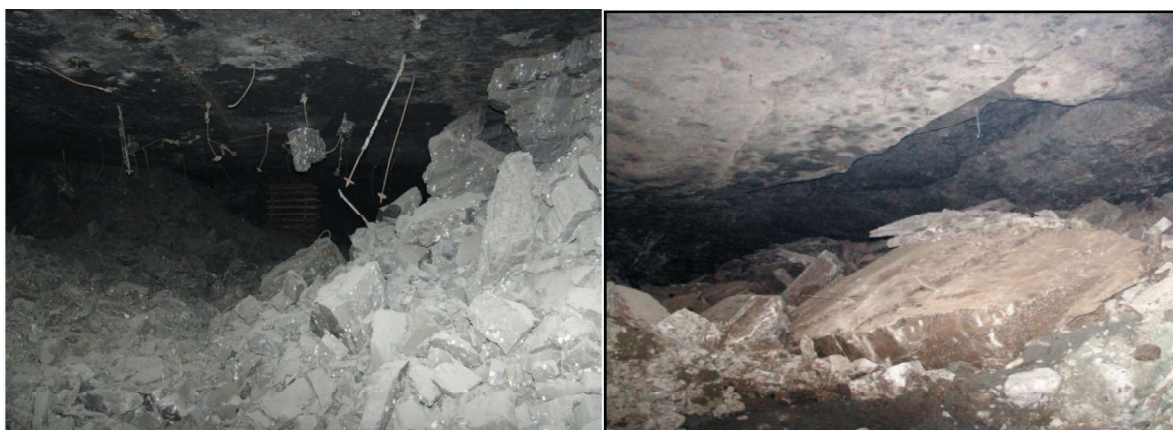
Rys. 1. Obwały stropu w wyrobiskach chodnikowych, a) opadnięcie skał pomiędzy kotew (fot. K. Skrzypkowski), b) odspojenie stropu powyżej poziomu kotwienia (photo: D. Juszyński)
