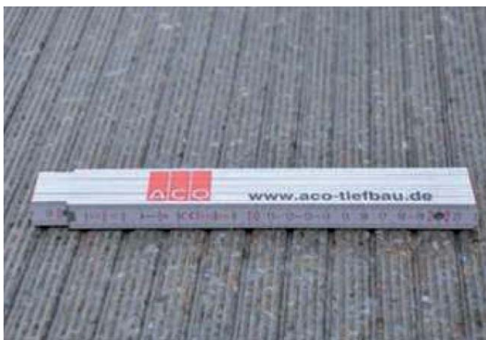
Fot. 7. Kombinacja metody grinding i grooving na nawierzchni: widoczne jej sfrezowanie ( grinding ) oraz rowki na nawierzchni w odległości co 20 mm ( grooving ) [5, 6]
