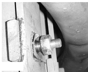
Rys. 7. Zerwane połączenie śrubowe elastycznego zawieszenia rdzenia.
