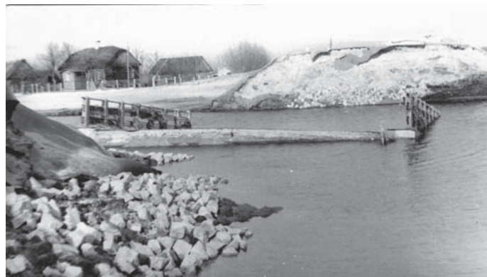
Fot. 4. Most w Kobylanach zniszczony w czasie powodzi [2]
