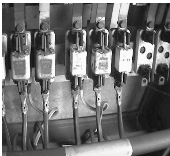
Rys. 2. Zdjęcie w świetle widzialnym pola liniowego rozdzielni niskiego napięcia
