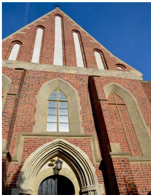
Ryc. 22. Zachodnia frontowa elewacja kościoła św. Władysława, zrekonstruowana w latach 1946–1947. Portal główny i laskowania okien w kształcie krzyża wykonane z wapienia pińczowskiego, ciosy obramień okiennych, cokoły pilastrów i gzymsy – z piaskowca szydłowskiego (Żukowski, 1948)
