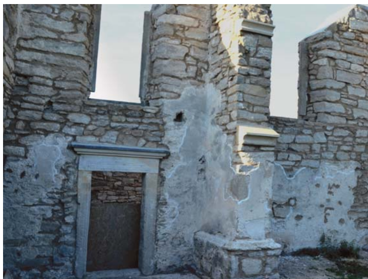
Ryc. 29. Ruiny kościoła Świętego Ducha – elewacja południowa z zachowanym portalem bocznym, wykonanym z wapienia pińczowskiego, pionowe elementy obramień okiennych i gzymsy przypory wyrzeźbione z tego samego materiału, ściany zbudowane z wapienia szydlowskiego, spojonego zaprawą glinianą
