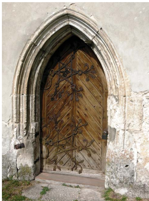
Ryc. 28. Ostrołukowy portal w południowej elewacji kościoła Wszystkich Świętych, wykonany z wapienia pińczowskiego Fig. 28. Ogival portal in the southern elevation of the All Saints Church made of the Pińczów limestone
